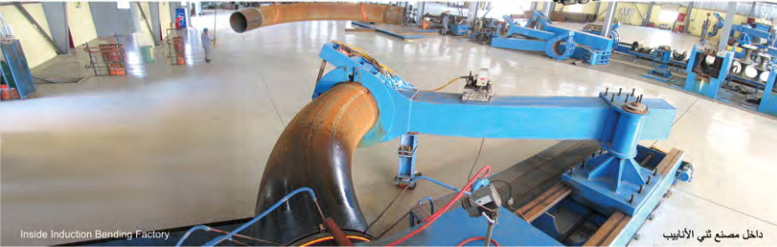
مصنع الأنابيب الكبيرة (يسار) ومصنع الأنابيب الصغيرة (يمين) في المدينة الصناعية الثانية بدمام . Large pipes factory to the left and small pipes factory to the right at Damman 2 nd Industrial City.
